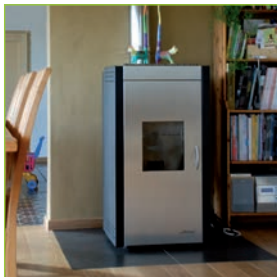
Un petit poêle-chaudière à pellets qui produit également l'eau chaude sanitaire (photo : pmp)
