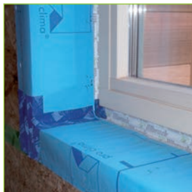
Etanchéité à l'air entre un châssis et un mur en ossature bois (photo : pmp)
