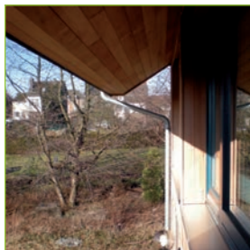
Débordement de toiture (photo : pmp)
