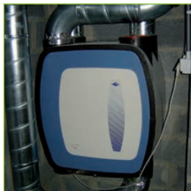
Groupe de ventilation double-flux (photo : Régis Verhosel)
